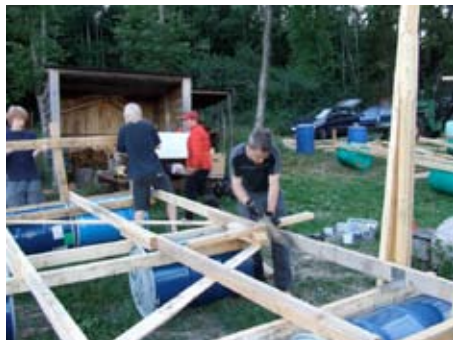
Det blev många förstärknings balka som ej var med i grund planen.
